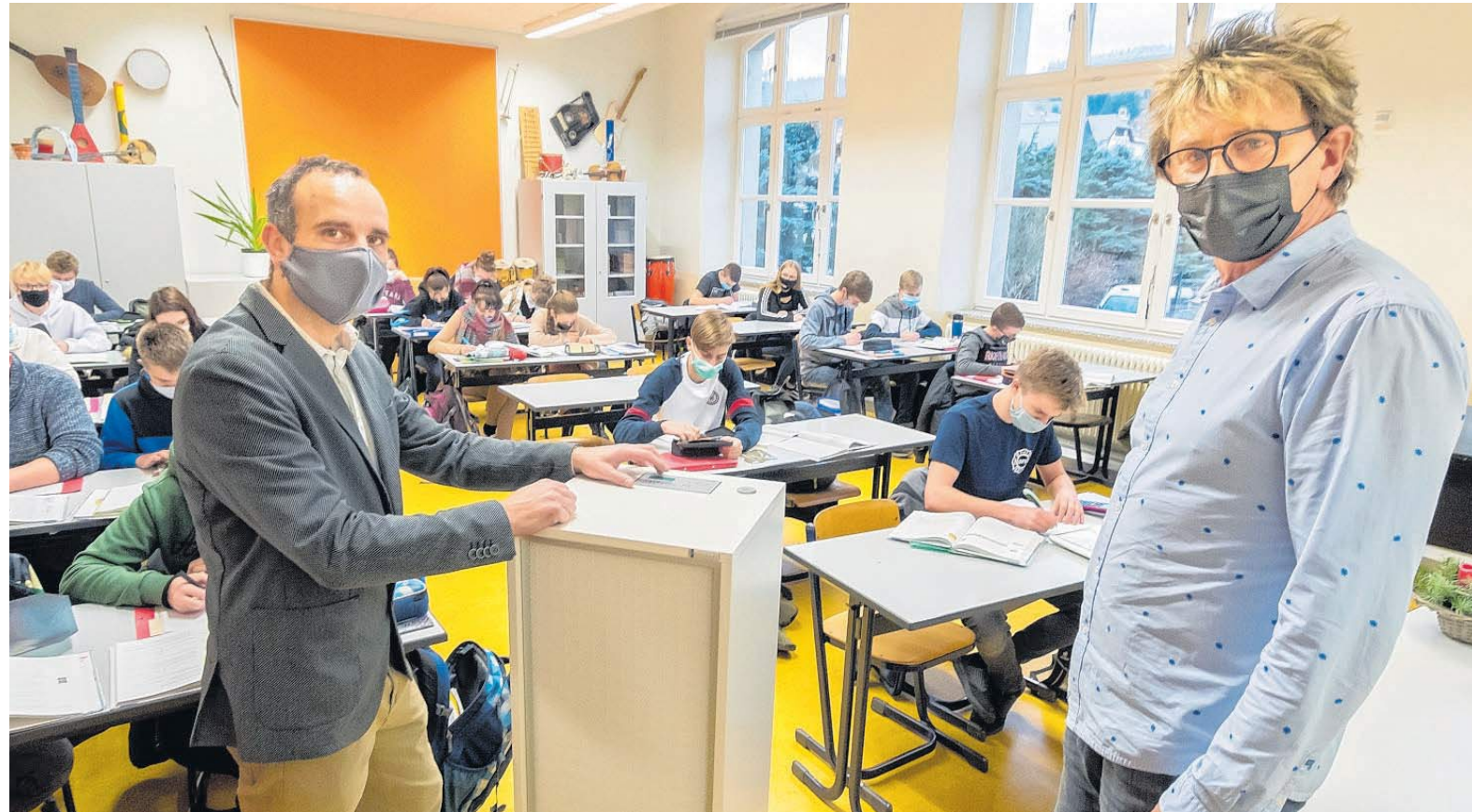
Tischlermeister Andreas Görg (l.) hat ein Exemplar des von ihm entwickelten und gebauten Luftreinigers „Air-Cleaner“ in einem Klassenzimmer der Olbernhauer Oberschule installiert und dabei Schulleiter Uwe Klaffenbach (r.) die Bedienung des Gerätes erklärt. Der Test fand vor dem Shutdown statt.
